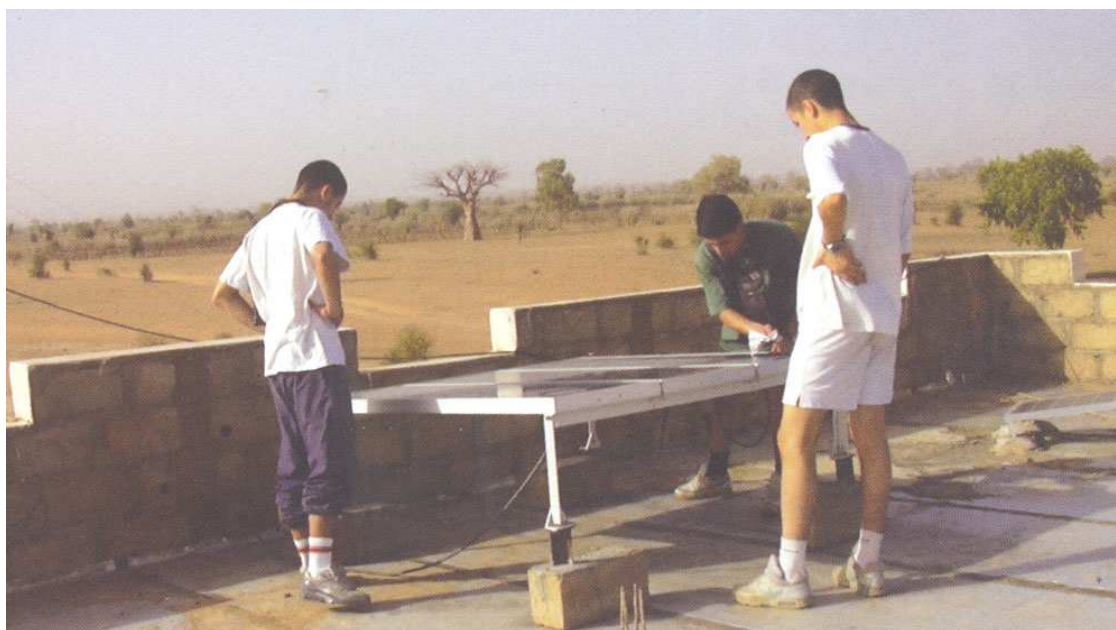
Élèves de BEP Métiers de l'électricité, Moussa et Hocine avec Mohamed achèvent l'installation du capteur solaire du CSCOM.
